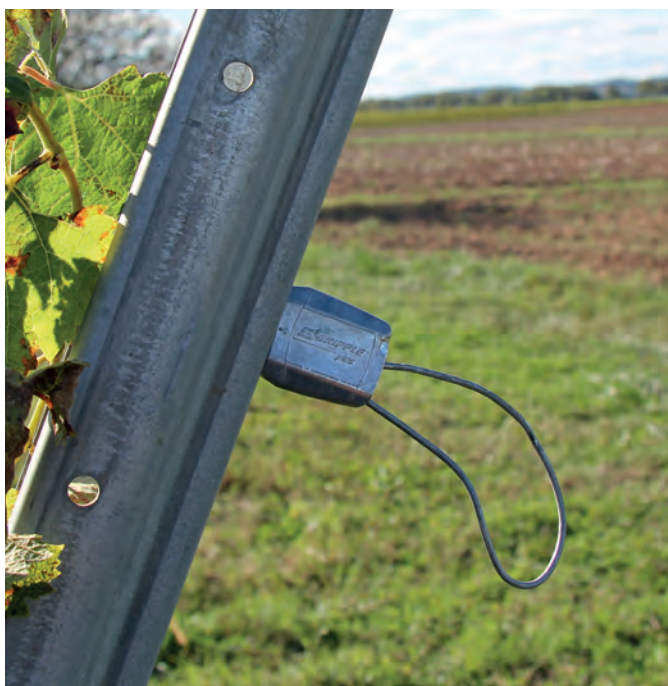
GP No. 1 nainstalovaná na ocelovém sloupku.
